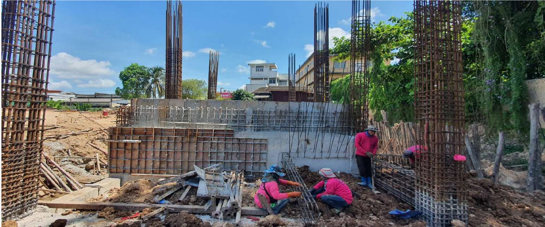
รูปภาพ งานก่อสร้างบ่อลิฟท์ อยู่ในงวดงานที่ 1
