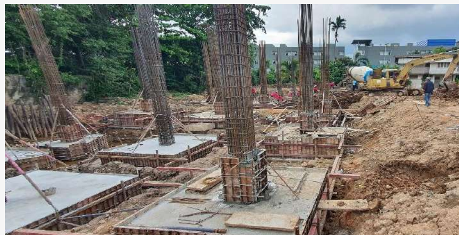
รูปภาพเตรียมงานก่อสร้างถังเก็บน้ำใต้ดิน-บ่อลิฟท์
